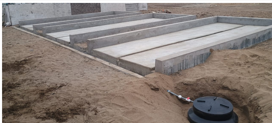
Vista del biodigestor (primer plano) y pozas para el proceso de compostaje
